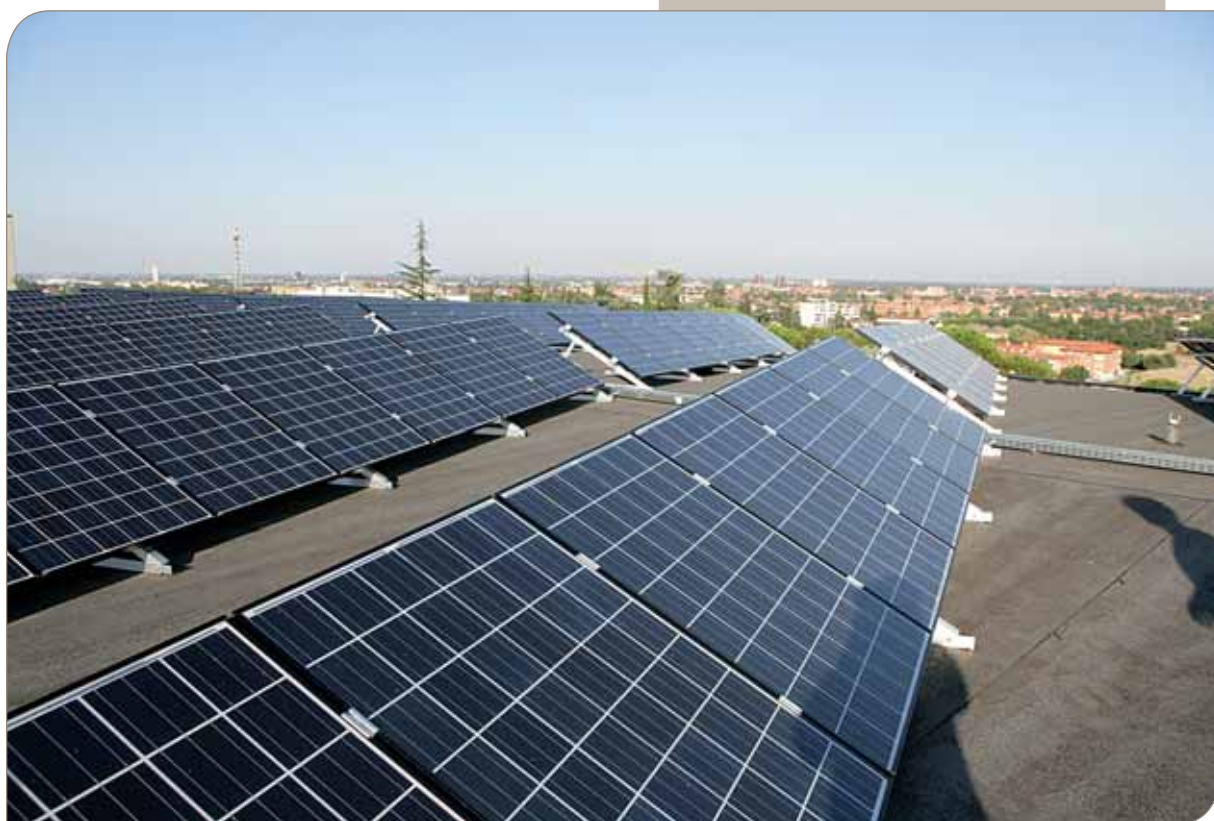
Impianto pannelli fotovoltaici
